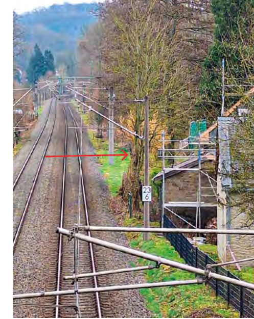
Abgestorbene Bäume im sicherheitsrelevanten Bereich der Gleisanlage.
